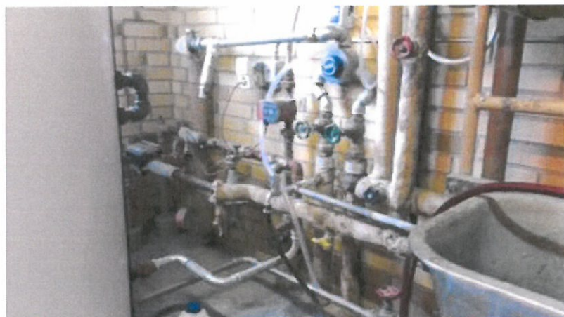
Fjernvarmehovedstik i teknikrum hal 1.jpg
