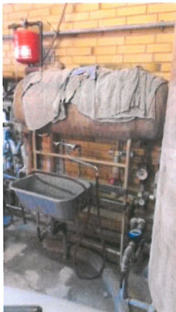
Beholder teknikrum i hal 1.jpg
