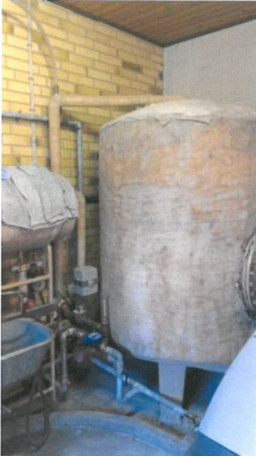
Varmtvandsbeholder teknikrum i hal 1.jpg
