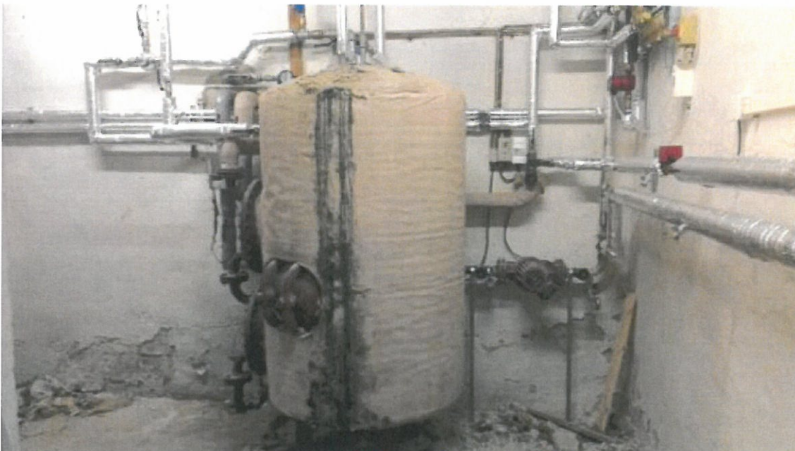
Varmeanlæg teknikkælder i hal 1.jpg
