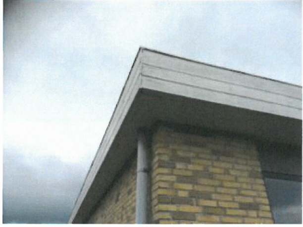
Nedbrudt bræddebeklædning på stern
