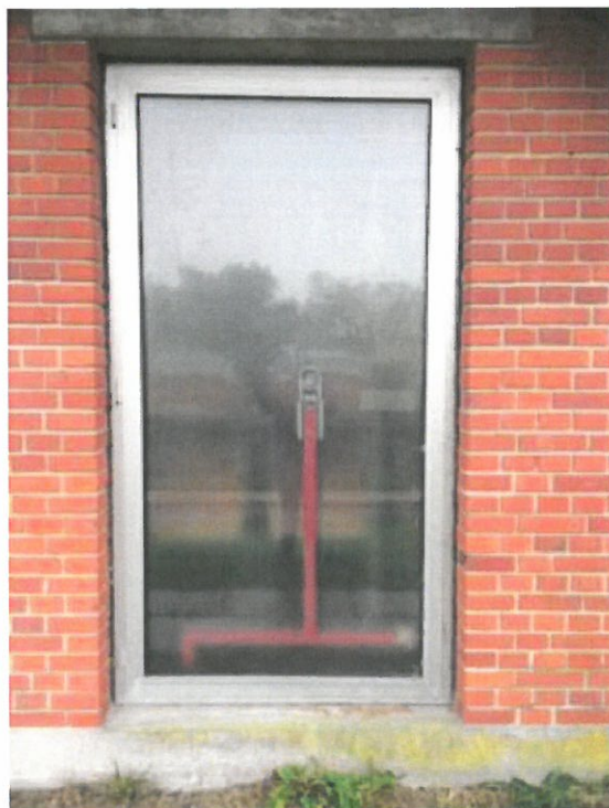
Alu-dør til teknikrum
