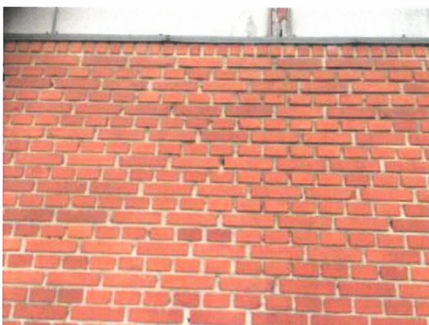
Murværk med dårlige fuger
