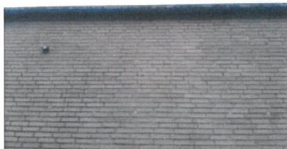
Dårlige fuger i murværk langs tagfod
