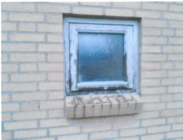
Vindue med slidt overflade
