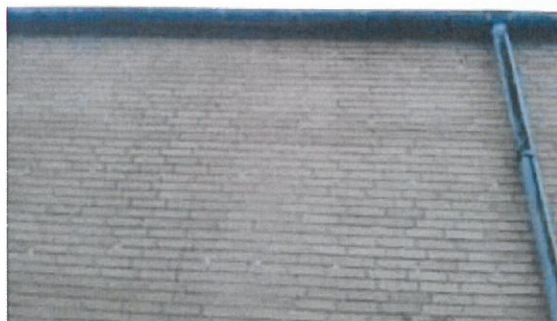
Dårlige fuger i murværk langs tagfod
